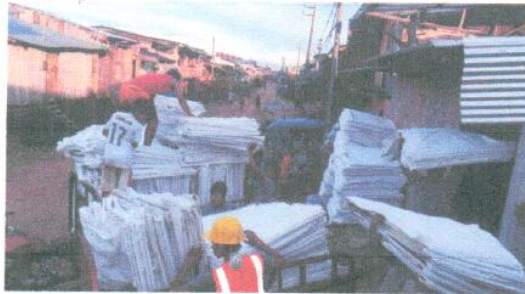
Vista panorámica: donde se observa el abastecimiento de cemento y BIGBAG en el almacén del proyecto.
