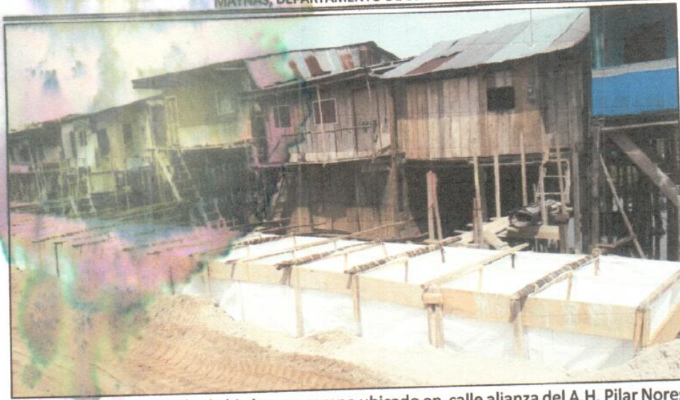
Imagen N°34: Instalación de big bag en campo ubicado en calle alianza del A.H. Pilar Nores de García.
