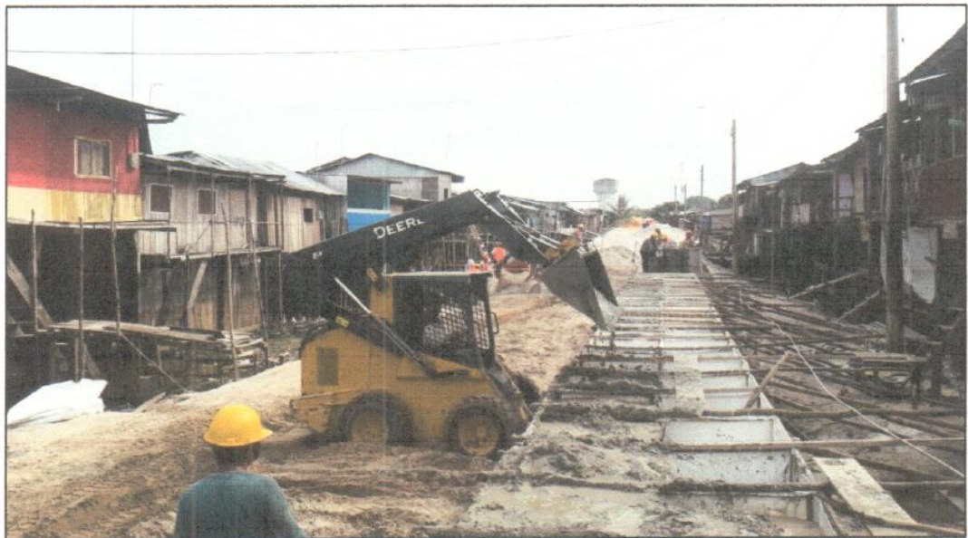
Imagen N°16: Trabajo de maquinaria pesada tipo "Mini-Cargador, se observa que los trabajadores cuentan con los equipos de protección personal correspondiente.
