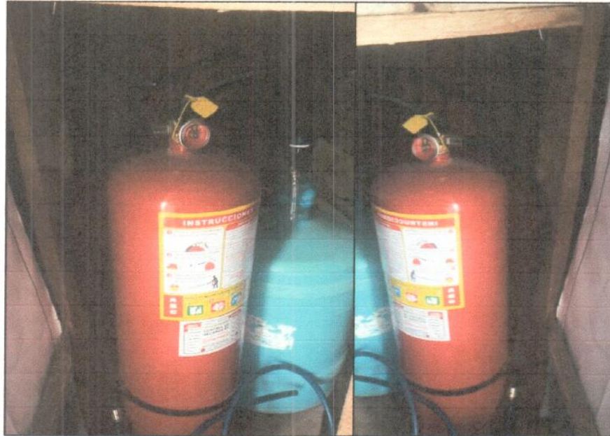
Imagen N°05: Implementación con materiales para incendios "Extintor", para respuesta rápida ante emergencias.
