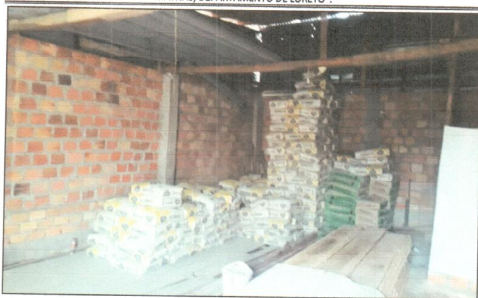
Imagen N°11: Recepción de bolsas de cemento, se observa una plataforma de madera el cual sirve como soporte y brinda estabilidad a las pilas de cemento almacenado.
